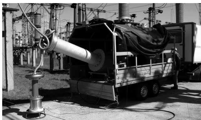
Рис. 9. Использование КГИ-200 на подстанции
